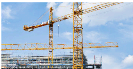
Grundsanierungen kosten rund 70 – 80 Prozent vergleichbarer Neubaumaßnahmen, gehen jedoch oft mit funktionalen Kompromissen und dauerhaft höheren betrieblichen Folgekosten einher. © SatyaPrem – pixabay
